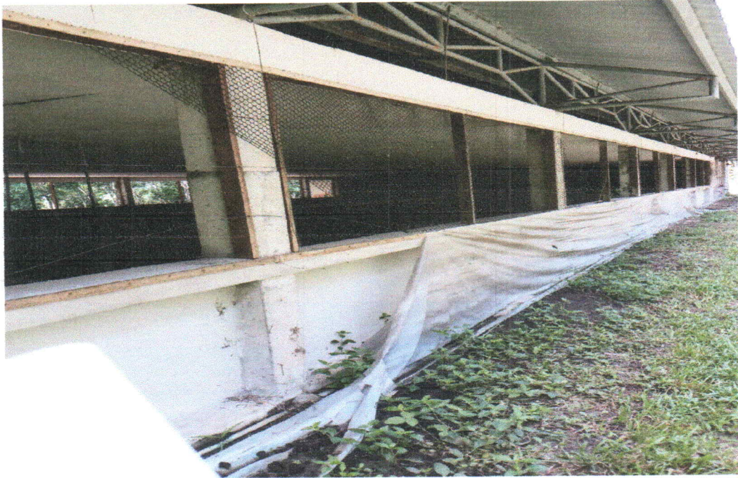
ผ้ายางกันรอบคอกสุกรระบบปิดที่เสื่อมสภาพไปตามเวลา (คอก ๑)
