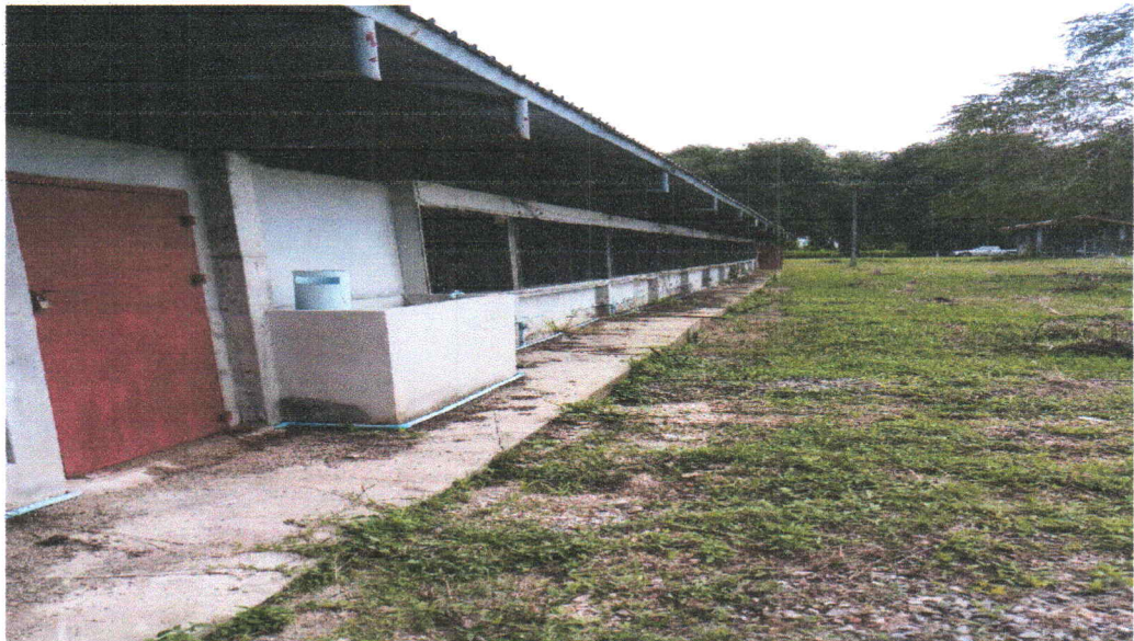
ผ้ายางกันรอบคอกสุกรระบบปิดที่เสื่อมสภาพไปตามเวลา (คอก ๒)
